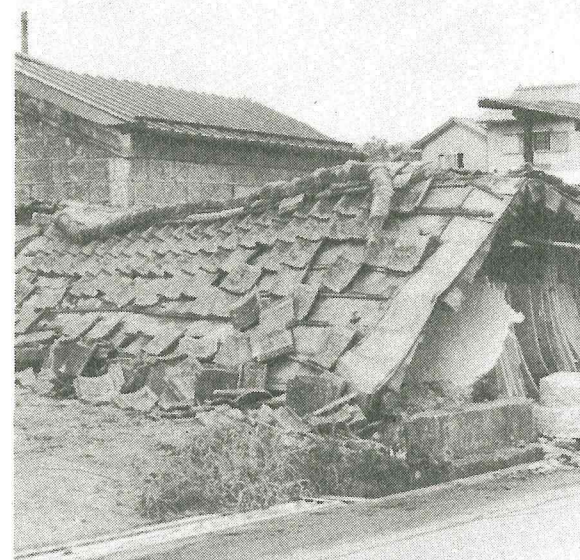
全壊した倉庫
