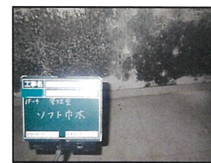
石綿含有建材写真
