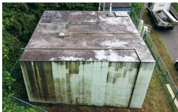
▲長期間雨風にさらされ劣化した状況
