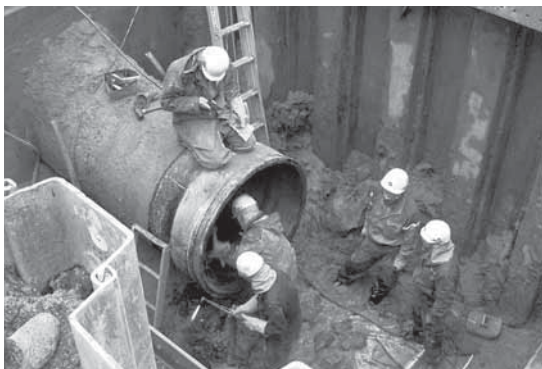
▲仙南仙塩広域水道の本管が再びはずれ断水した
