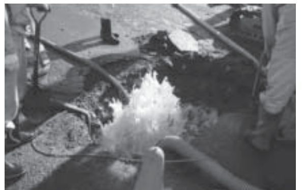
▲大きな被害とならないよう、漏水は早期の発見、復旧が必要です。
